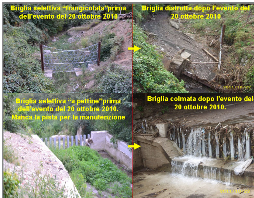
Figura 11: esempio di briglie mal concepite e realizzate nel bacino del Torrente Dragone a monte di Atrani dopo il disastro idrogeologico del 9 settembre 2010.
